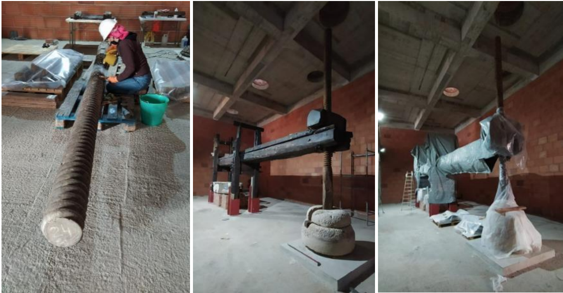
Neteja cargol, muntatge premsa i protecció.
