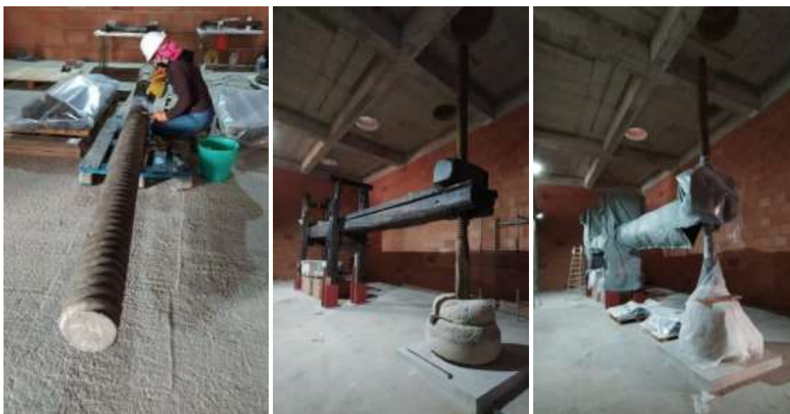
Neteja cargol, muntatge premsa i protecció.
